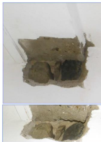
LA TRAVE NON SI AMMORSA NELLA MURATURA
