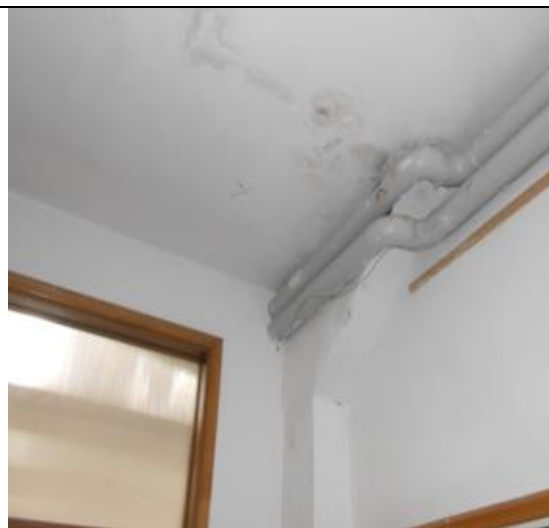
Infiltrazioni corridoio al piano terra
