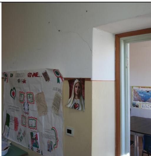
Lesione su muratura al piano terra
