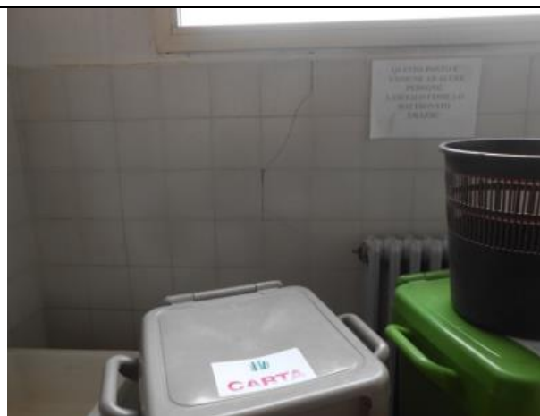
Lesione su muratura al Piano Primo
