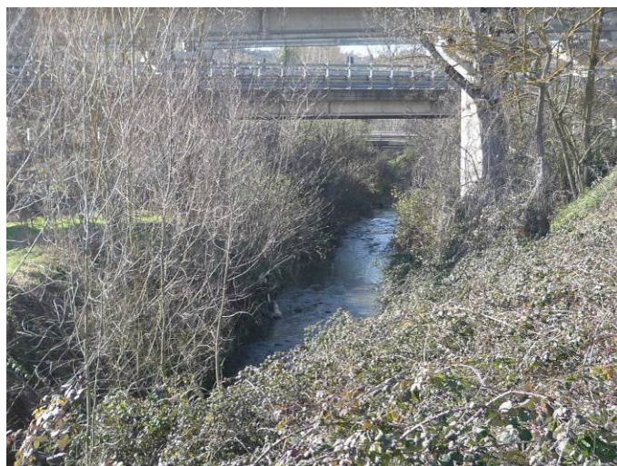
foto 2- Interferenza fra il torrente e le pile Viadotto E78 da valle (sezione 390)
