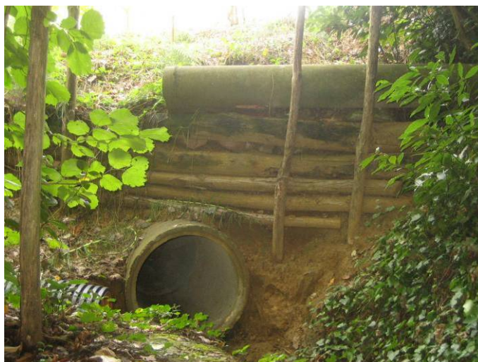
foto 14 – Sbocco del tratto tombato d.600 mm del fosso in loc.tà Bottega Nuova (sezione 9.5)
