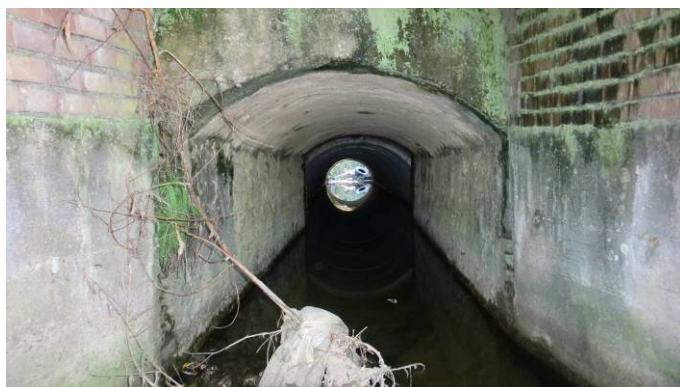
foto 20 –Sbocco scatolare fosso S. Lucia a monte della linea ferroviaria (sezione LU11.1)
