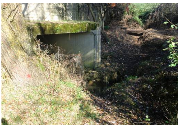
foto 22 –Sbocco dello scatolare del F.sso Fossatone dalla zona industriale di Isola d'Arbia (sezione 0.8)
