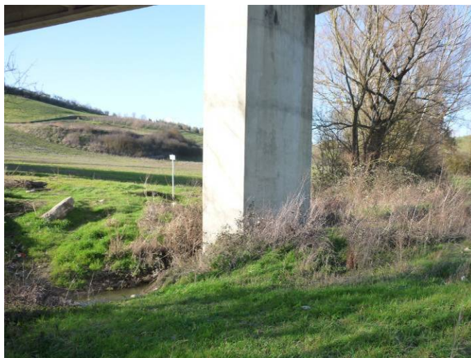
foto 30 –Vista fosso del Casone con interferenza pila dell'omonimo viadotto(sezione 20)
