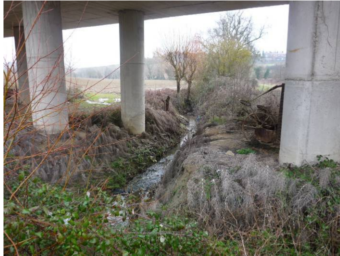
foto 28 –Vista da monte della zona di interferenza fra il fosso di Valli e l'omonimo viadotto (sezione 20)
