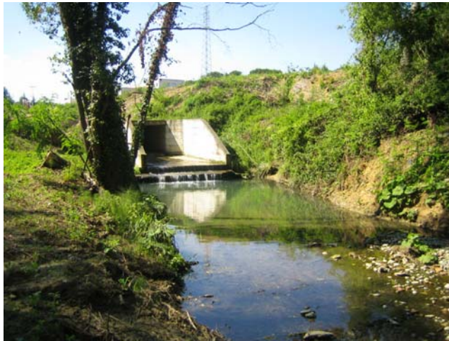
Foto 8 - sbocco del tratto tombato a monte del parcheggio in loc.tà Due Ponti (sezione 54)
