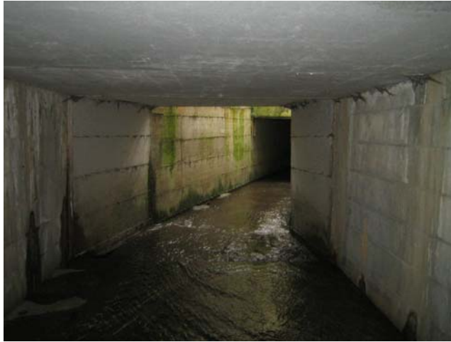
Foto 7 - interno tratto tombato a monte dello sbocco in prossimità del parcheggio in loc.tà Due Ponti
