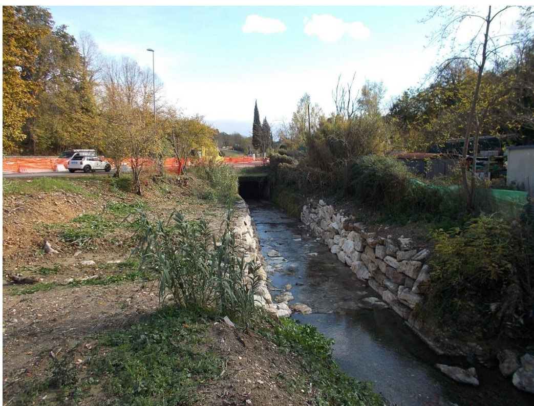
Figura 6.45 - Sezione in uscita tombamento sotto attraversamento del Riluogo della Strada del Ruffolo
