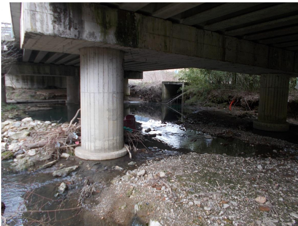
Figura 6.21 - Tratto in cui il Tressa sotto attraversa la tangenziale ovest. Immissione del Pescaia completamente tombato
