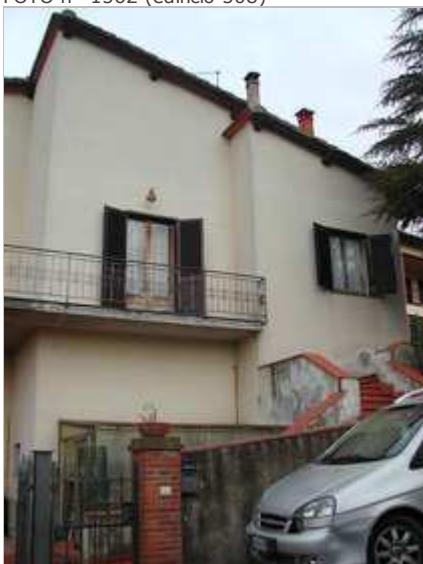
Categoria: Degrado architettonico/incongruità
