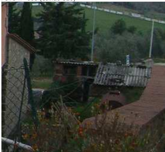
Categoria: Degrado architettonico/incongruità
