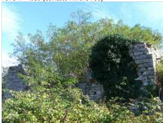
Categoria: Degrado fisico
