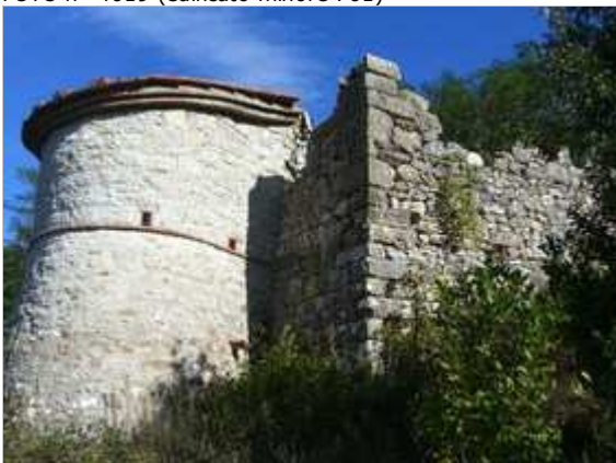
Categoria: Degrado fisico
