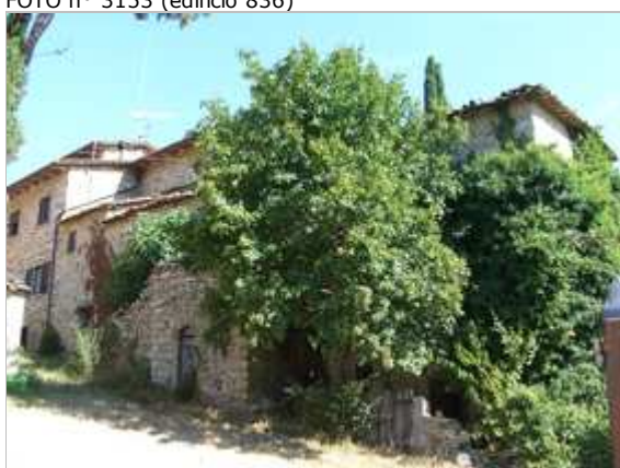
Categoria: Degrado fisico
