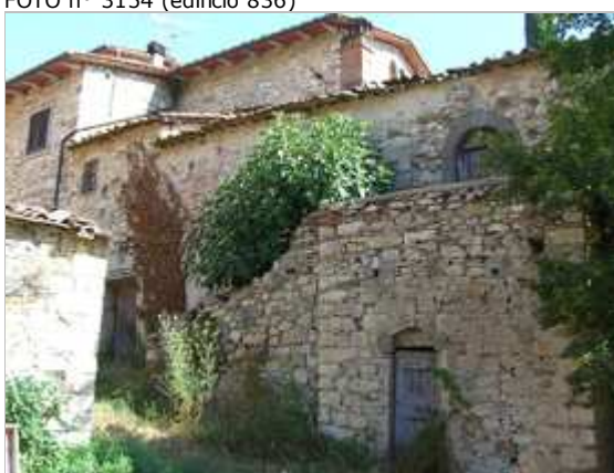
Categoria: Degrado fisico
