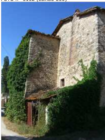
Categoria: Degrado fisico
