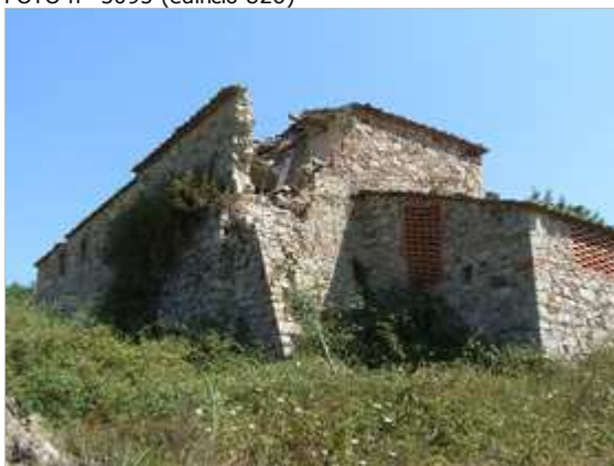
Categoria: Degrado fisico
