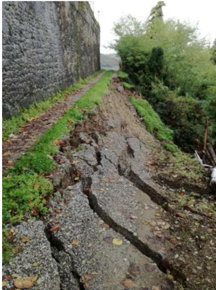
fig. 5:Frana prospiciente Via Giacomo Matteotti – Radda in chianti (dicembre 2019)
