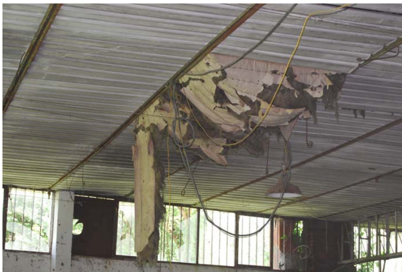
Particolare dello sfaldamento della copertura.
