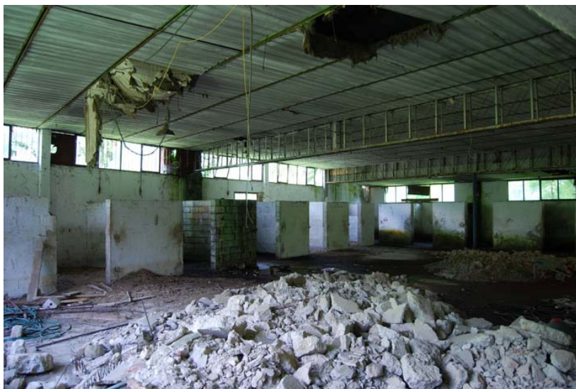
Capannoni adiacenti all'edificio storico costruiti durante la fase in cui il complesso fu adibito a tacchificio.
