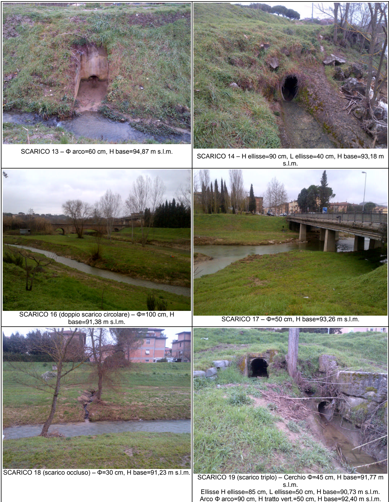
Fig. 55 – Fotografie degli scarichi aperti lungo il tratto urbano arginato del Torrente Staggia
