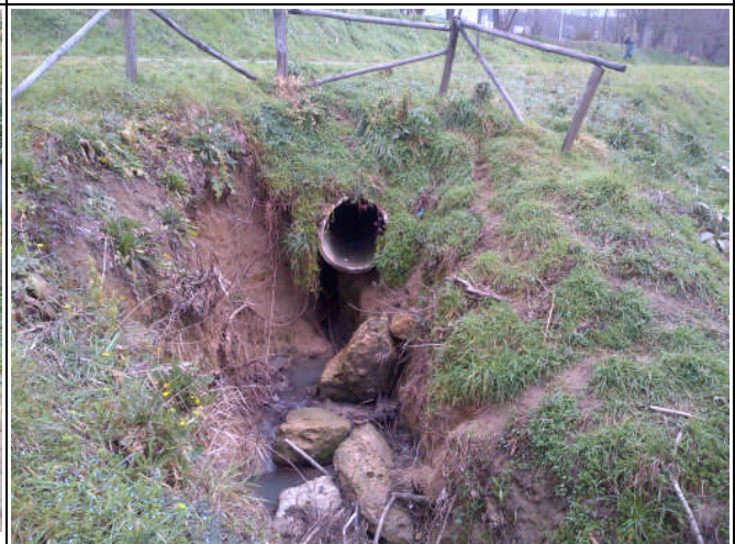
SCARICO 5 – \Phi=60 cm, H base=98,92 m s.l.m.
