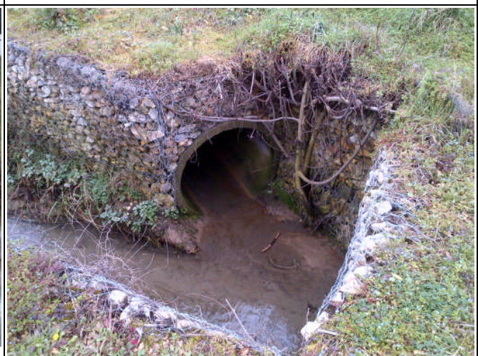
SCARICO 12 – \Phi=90 cm, H base=94,64 m s.l.m.
