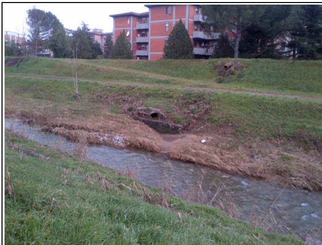
SCARICO 1 – \Phi=60 cm, H base=98,49 m s.l.m.
