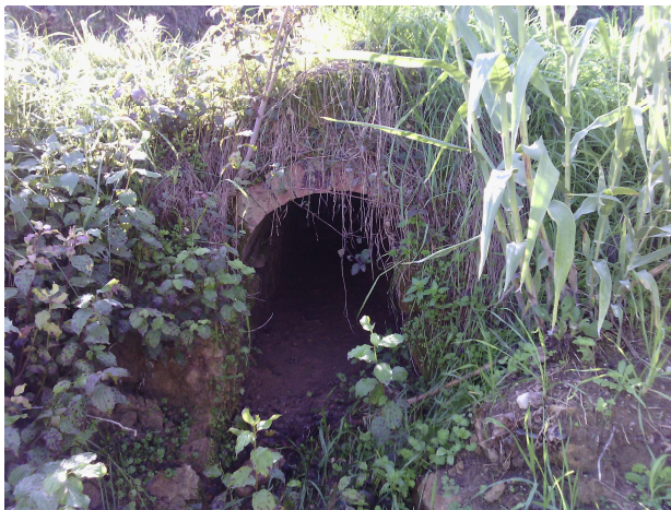
Uscita attraversamento su strada campestre di MV46531 a monte della Variante SR2
