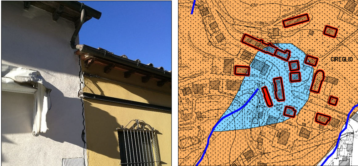
Sinistra: esempio di lesione strutturale; destra: ubicazione del corpo di frana attivo (celeste) e degli impluvi della zona. Sono inoltre messi in evidenza gli edifici censiti (il poligono rosso indica l'edificio con la lesione mostrata nella foto a sinistra)
