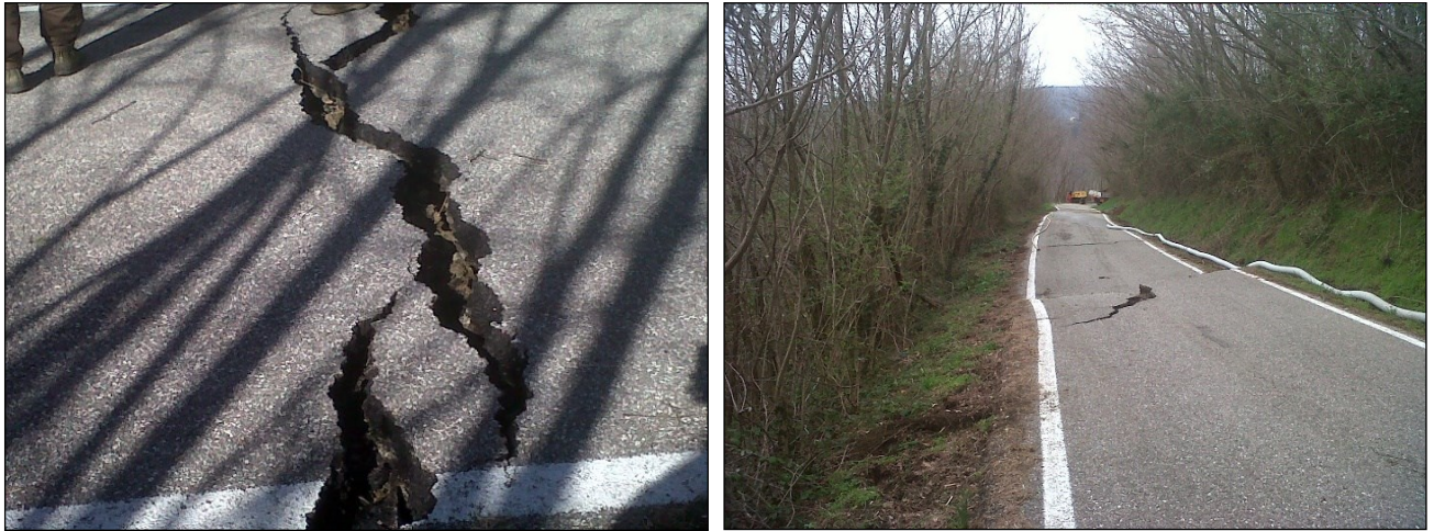
Lesioni del manto stradale – Via di Arcigliano (2013)
