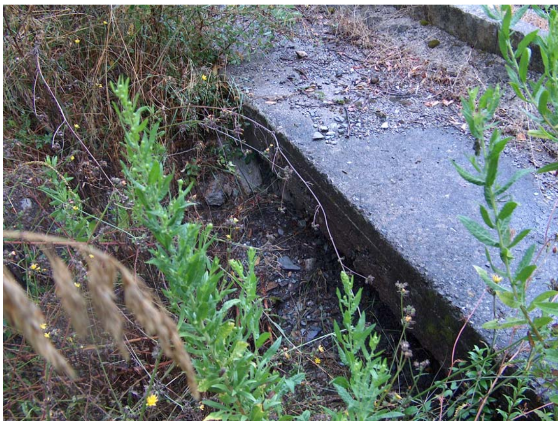
Vista del tombino esistente sul fosso senza nome a monte della S.P. Panoramica di Porto Ercole.
