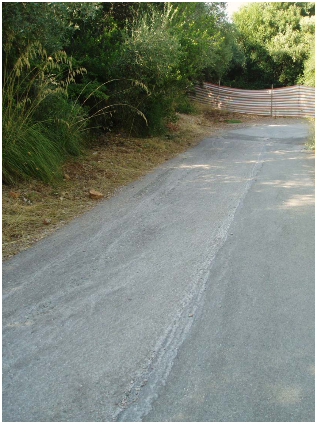
Vista della strada in adiacenza all'agglomerato esistente a monte della S.S. n. 440. L'immagine è ripresa immediatamente a valle dei campi sportivi dove il fosso termina il suo percorso, e dove le acque vengono convogliate in maniera casuale sulla strada verso valle.
