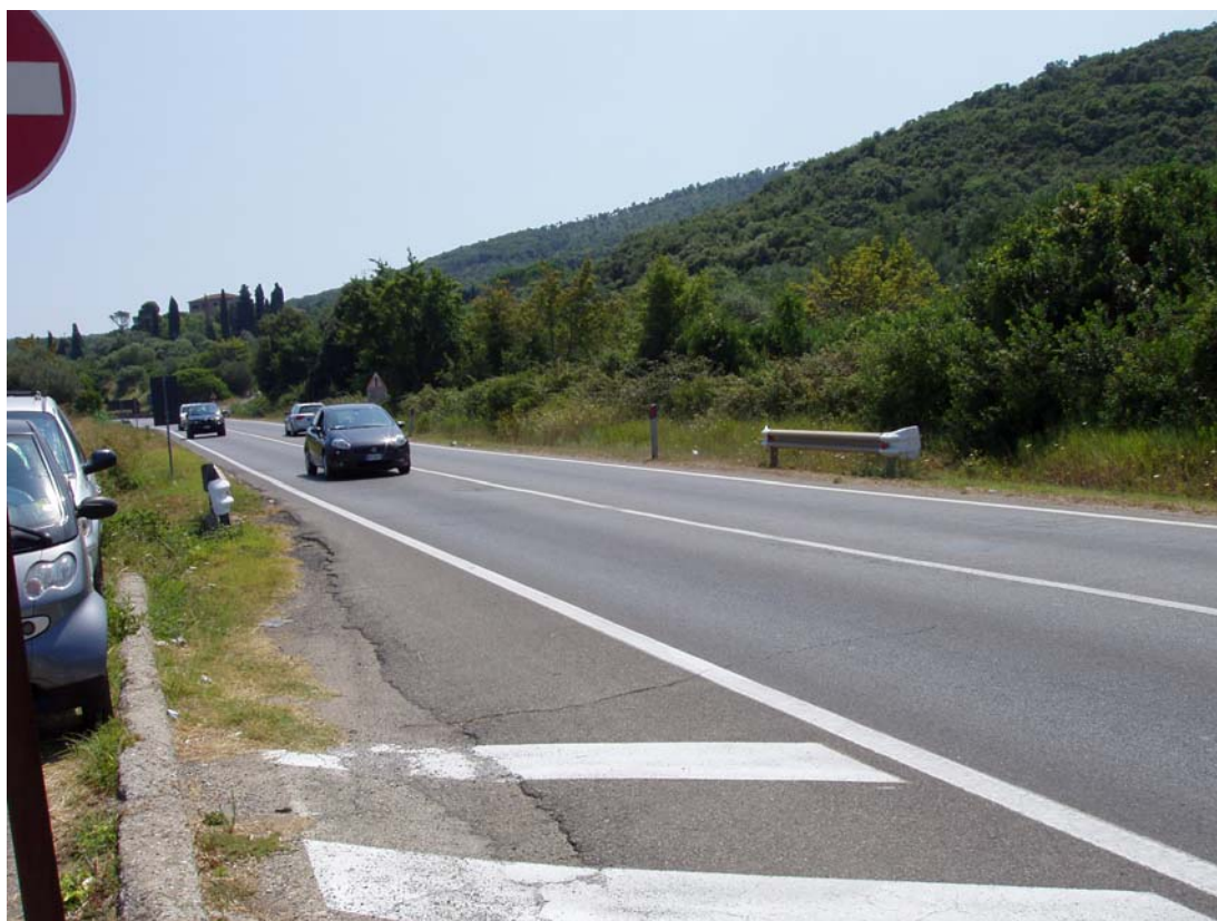
Vista della S.S. n. 440 di Porto Santo Stefano in corrispondenza dell'area oggetto della previsione urbanistica. Il tombino esistente è l'unico presente nel tratto di strada a monte della nuova previsione urbanistica e non è in corrispondenza dei fossi come indicati nella cartografia del P.A.I..
