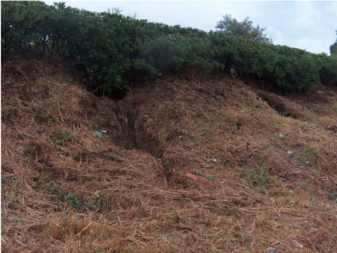
Particolare di alcuni punti in cui l'acqua arriva sulla spiaggia dalla strada in corrispondenza della Valle Spinosa.
