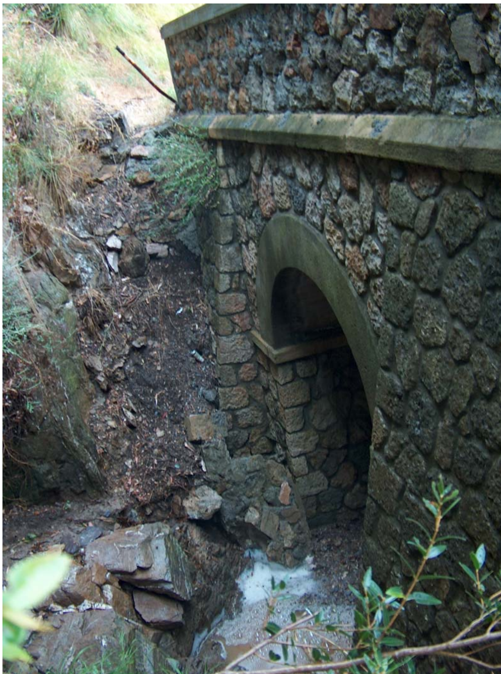
Vista del ponticello sul fosso Pulendona, di notevoli dimensioni, più per ragioni morfologiche (la valle risulta fortemente incisa e quindi per mantenere la quota della strada è stato necessario costruire un manufatto importante) che non per ragioni idrauliche considerate le portate in gioco.
