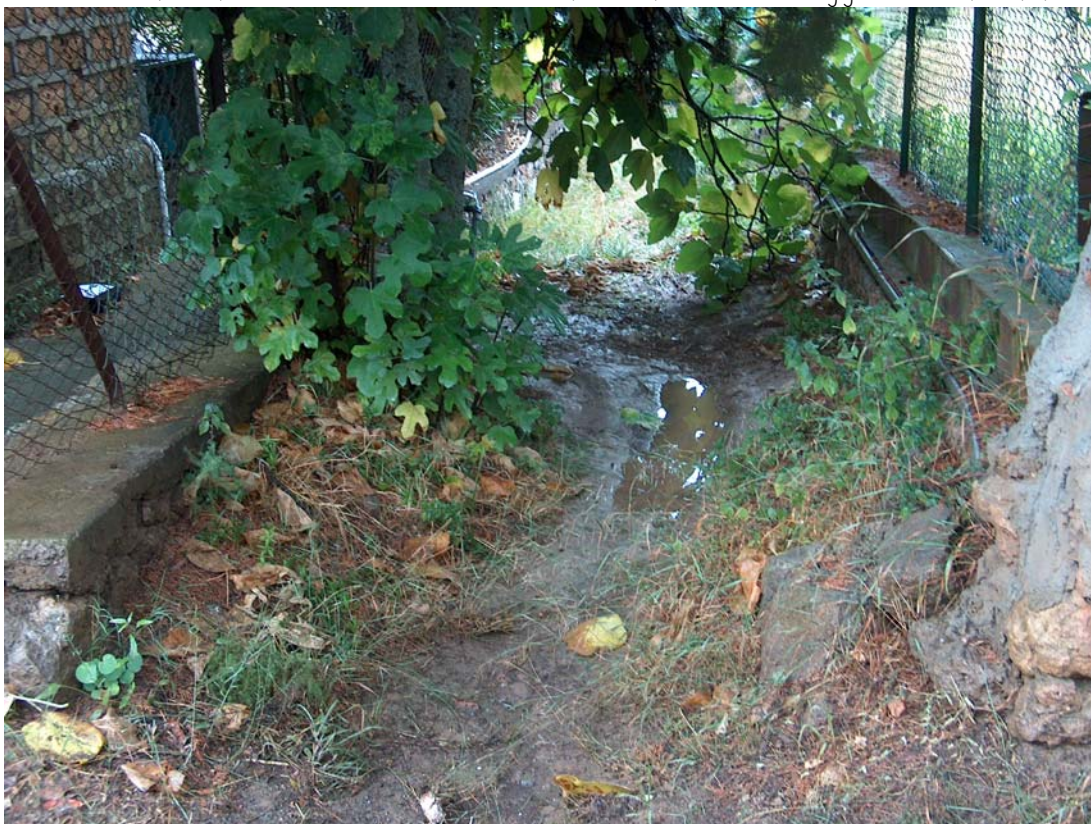
Vista del fosso del Pozzoni nel tratto a monte della S.P. n. 161 di Porto Santo Stefano (o anche S.S. n. 440), marginalmente interessato dalle acque che fanno percorsi diversi sul terreno anche per le diverse ostruzioni che si hanno lungo il tracciato (il fosso è in pessimo stato di manutenzione).
