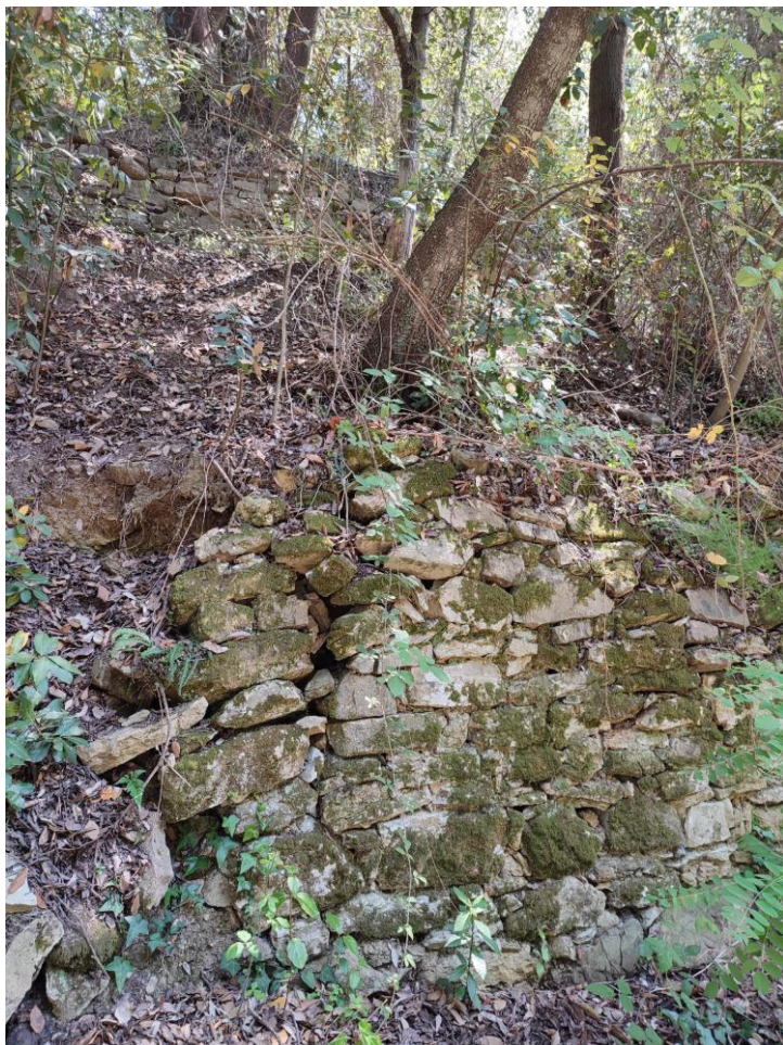
Porzioni di terrazzamenti in cattivo stato di manutenzione, con crolli in alcuni punti. La vegetazione presente indica uno stato di rinaturalizzazione avanzato.
