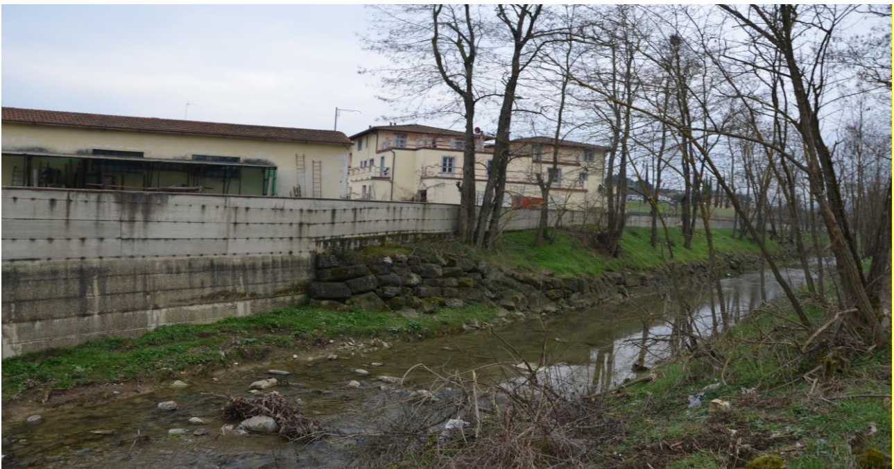
Figura 5.5 - Argine, in destra idraulica, nei pressi della zona industriale di via G. Pastore.
