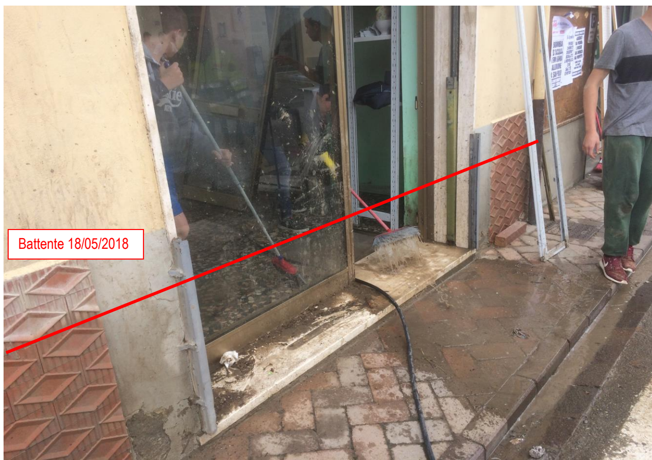
Figura 9.10 – Alluvione 18/05/2018, Via Poggio alla Croce, battente sugli edifici commerciali durante l'evento critico.
