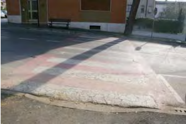
FOTO n° 446 (Attraversamenti pedonali ID 5)
