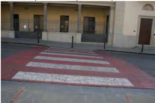
FOTO n° 512 (Attraversamenti pedonali ID 16)
