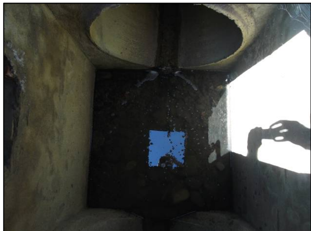
Foto 3.9 Lottizzazione industriale Botriolo. Pozzetto ispezione condotta fognaria CLS DN 800.
