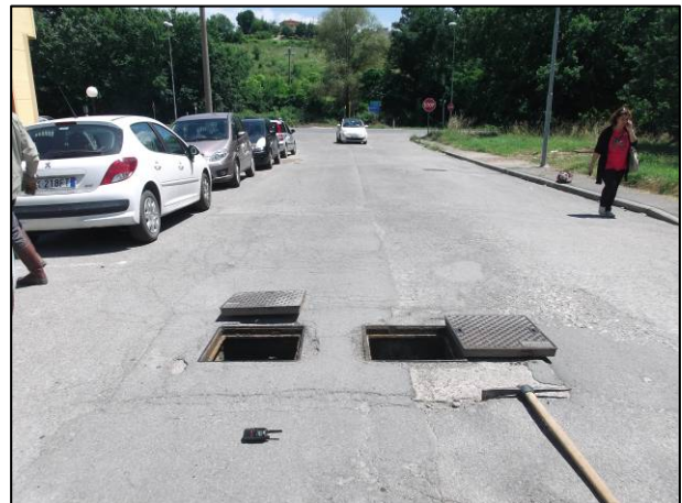
Foto 3.8 Lottizzazione industriale Botriolo vista verso valle. Pozzetto ispezione condotta fognaria CLS DN 800.
