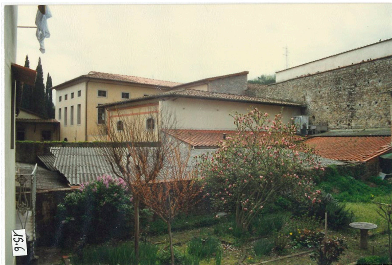
l'area interna con i manufatti da rimuovere e riconfigurare (dalla schedatura del R.U.)
