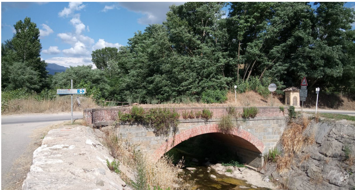
Figura 3.14 – Il ponte ad arco in muratura esistente. Sulla destra, la piccola edicola votiva in muratura.
