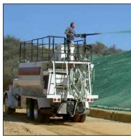
FASE 3 Spargimento meccanico della miscela prevista (semi di leguminose e graminacee) comprensiva di fertilizzanti e mulch di legno sul rilevato precedentemente livellato.
