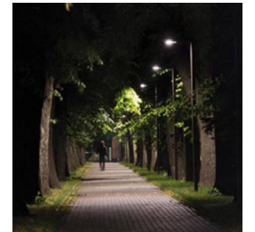
Illuminazione percorsi esterni
